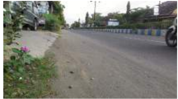
Gambar 3.1 Kondisi Bahu Jalan Segmen 1
